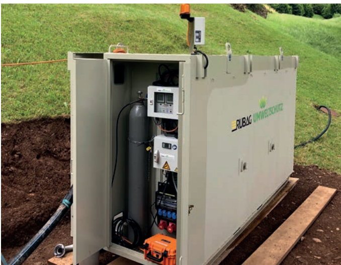
Aus unserem MietPark: 10 m 3 Becken mit automatischer Neutralisation
