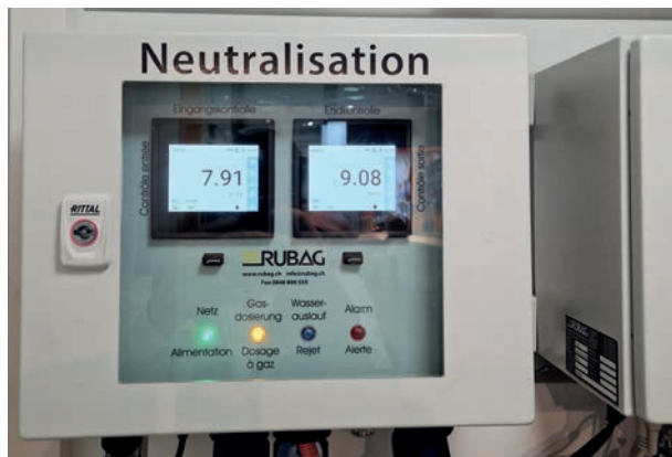
Neutralisationsanlage mit Touch Display
