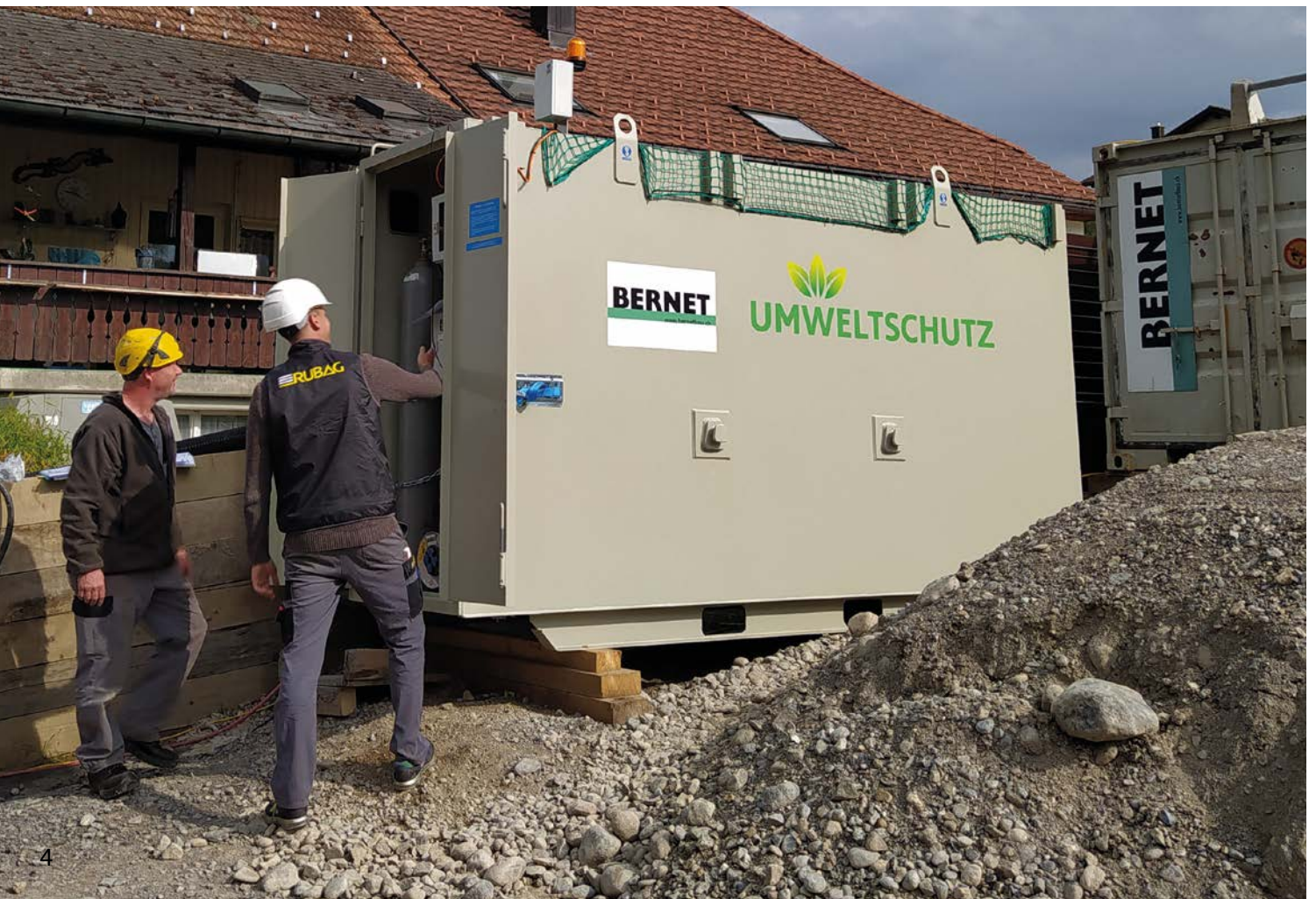
Fachberatung durch unseren Spezialisten auf der Baustelle der Firma Bernet in Gommiswald. Auf dieser Baustelle kommt ein kompaktes 10 m 3 Becken zum Einsatz.
